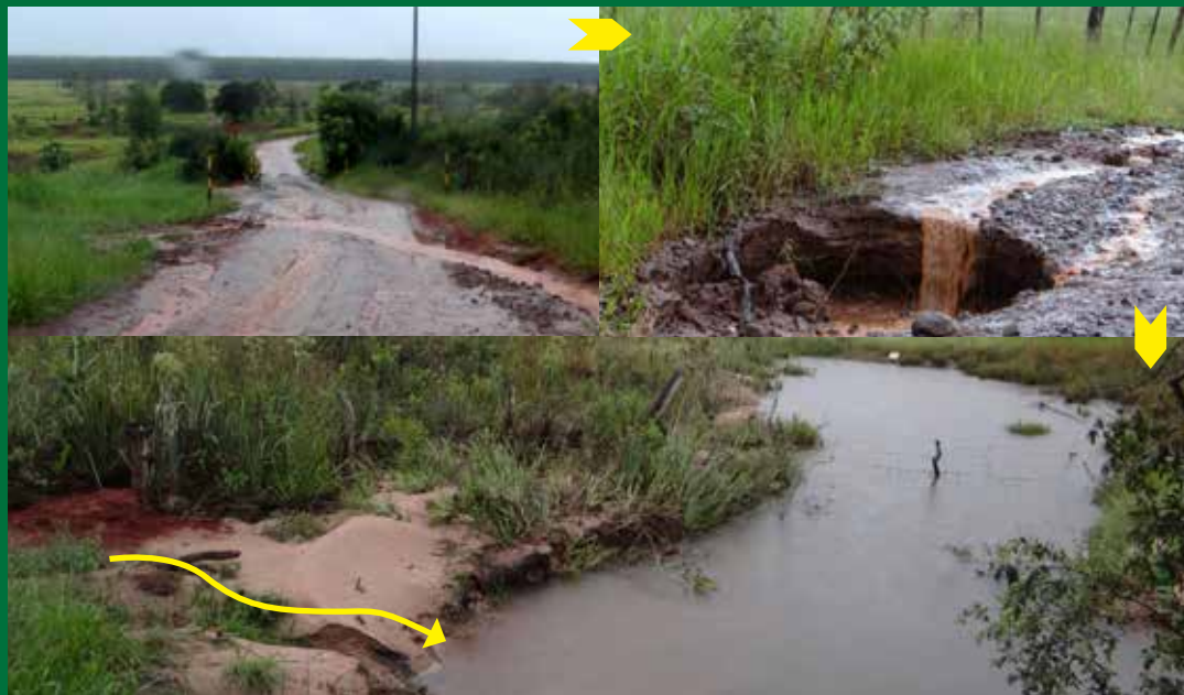
Figura 19: Estrada com ausência de conservação, carreando sedimentos para curso d' água.
